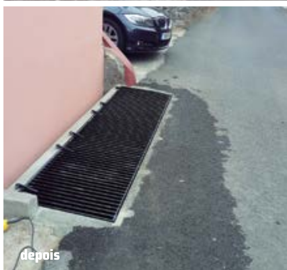
→ Colocação de Grelha nos Canhas Colocação de uma grelha inexistente no Lombo do Meio, Canhas
